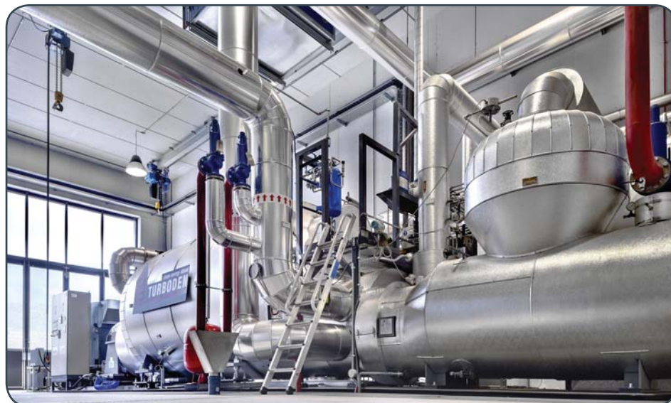
Комплекс получения электроэнергии на биомассе 800 кВт
